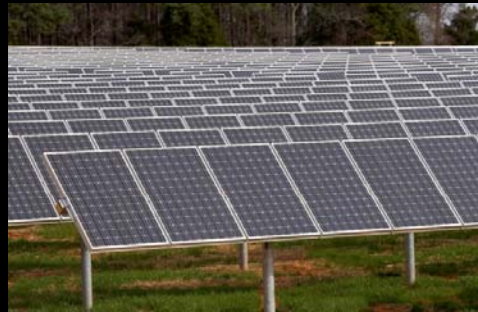
SAS SOLAR ARRAY
